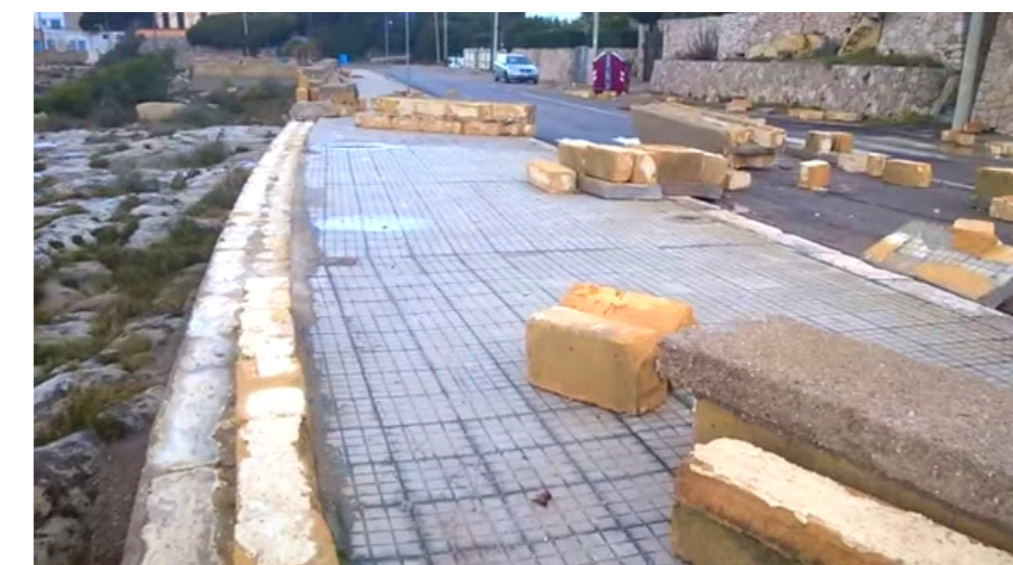
13. Muro danneggiato durante l'ultimo evento di mareggiata
